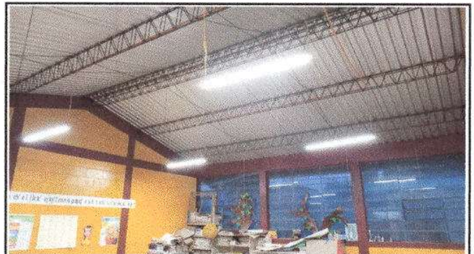
Foto 4: Sustrucción de lámparas tipo Led
